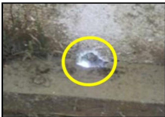
壁等の破損修繕
